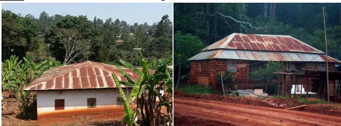
Figure 28 : altération de la tôle en acier galvanisé
